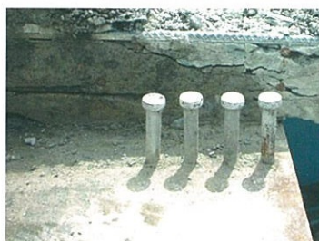
⑥ 床版の破碎状況
