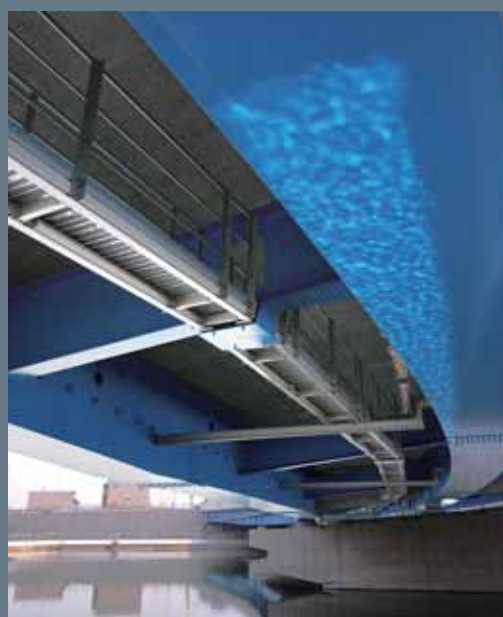
件名：佐保川橋 施主：西日本高速道路株式会社 場所：奈良県大和郡山市
