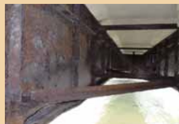
未点検の橋梁桁間では、環境により腐食が進行している場合があります。
