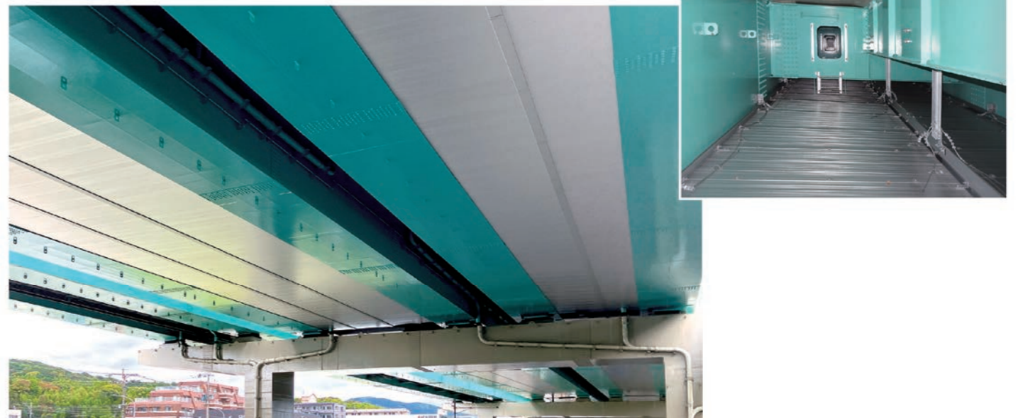
福岡高速 2 号橋 (金の隈～大野城) / 福岡県 既設橋に設置
