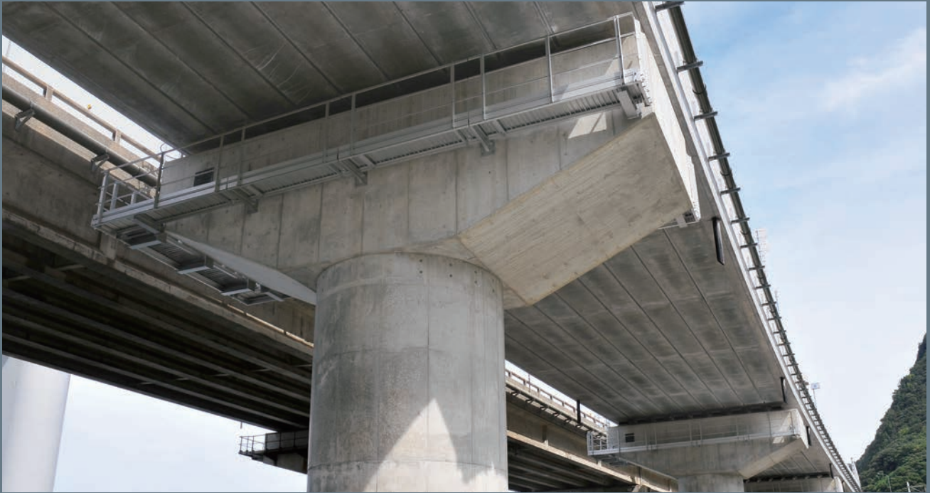
件名：歌高架橋 施主：国土交通省北陸地方整備局高田河川国道事務所 場所：新潟県糸魚川市
