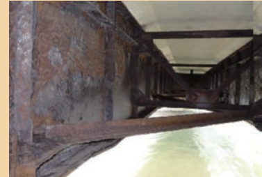
未点検の橋梁桁間では、環境により腐食が進行している場合があります。
