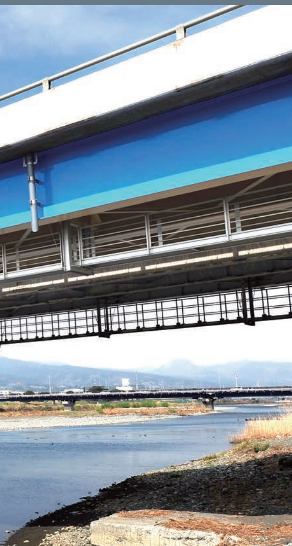
件名：西湘大橋 施主：中日本高速道路株式会社 場所：神奈川県小田原市
